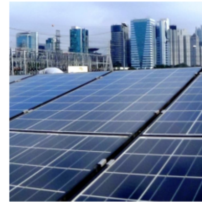
PROJECT - Pinheiros River PV PROJETO - FV Rio Pinheiros
