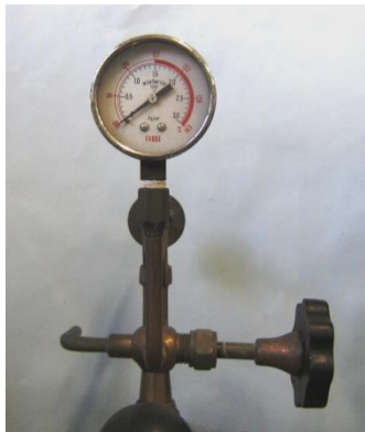
Válvula de exaustão e manômetro
