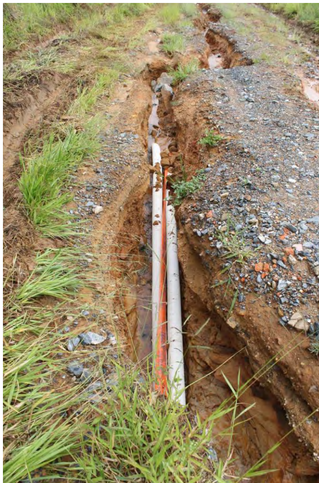
Figura 3.20 – Efeito da erosão na estrada do Morro Araçoiaba.
