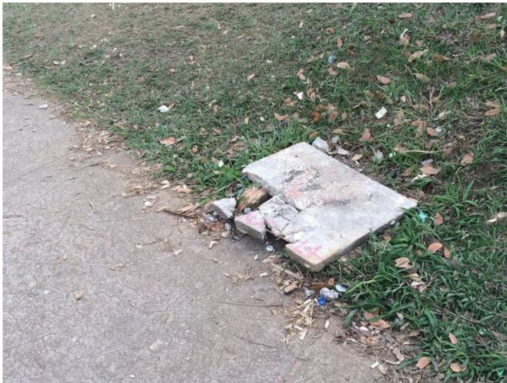
Estrutura da praça está degradada (Foto: Márcio Pinho/G1)
