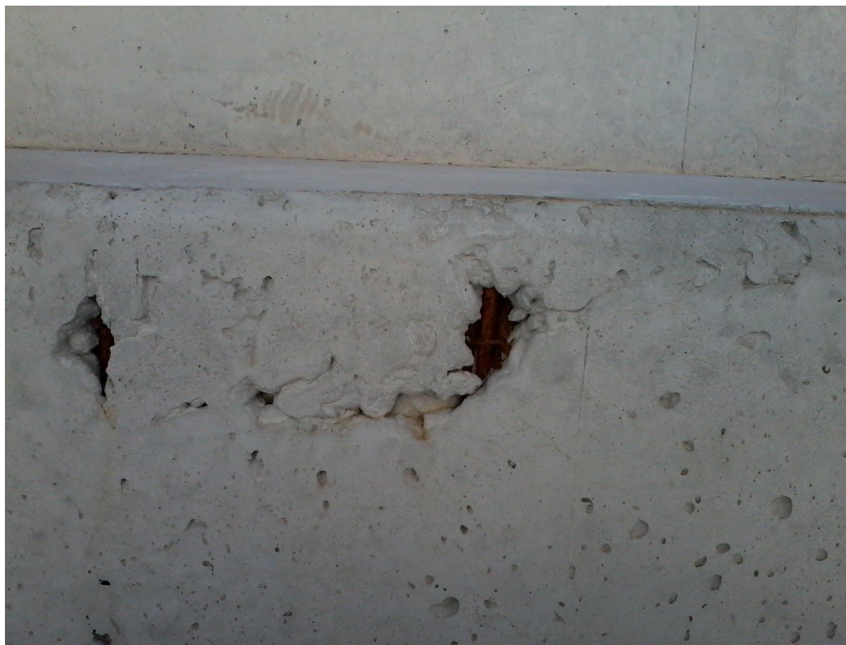
Figura 3 – Falhas de concretagem Fonte: Dados produzidos pelo autor (2012)
