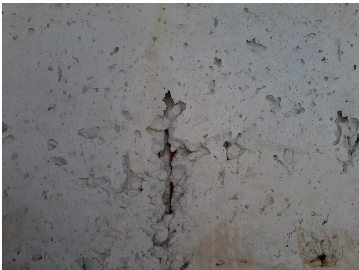
Figura 4 – Falhas de concretagem Fonte: Dados produzidos pelo autor (2012)
