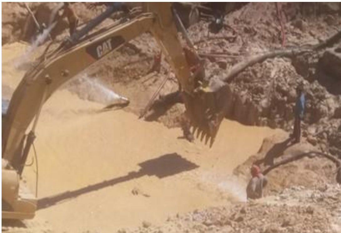
Figura 35 – Operador próximo à área de operação da escavadeira, em condição de risco, Peixoto de Azevedo (MT)
