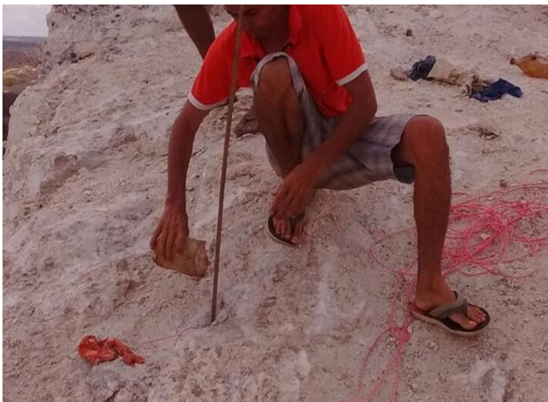
Figura 36 – Situação de risco devido ao manuseio e carregamento de explosivos, Equador (RN)
