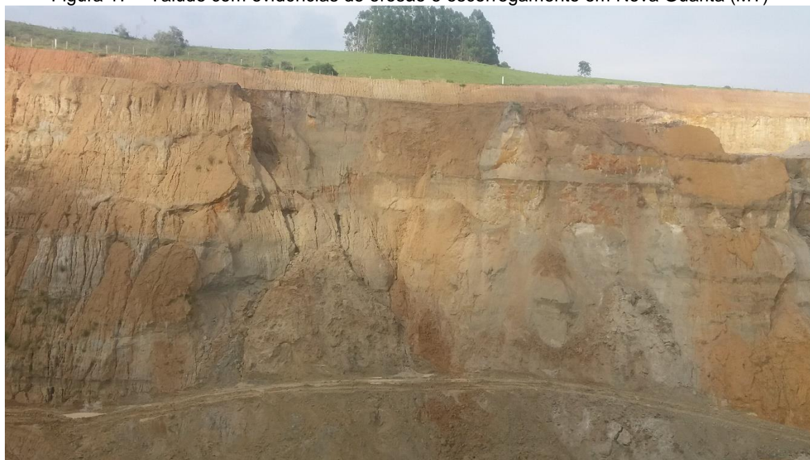
Figura 17 – Talude com evidências de erosão e escorregamento em Nova Guarita (MT)
