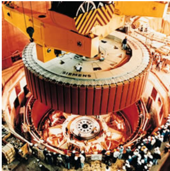
Rotor e estator de unidade geradora de Itaipu 700 MVA
