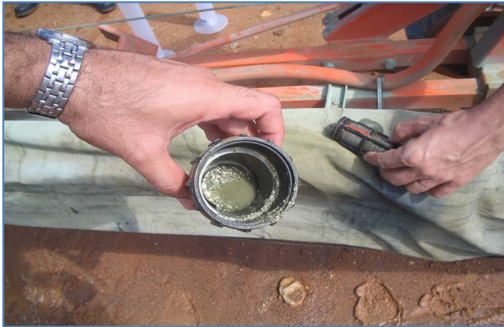
Filtro com necessidade de limpeza
