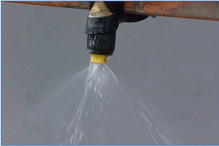
Bico com vazamento
