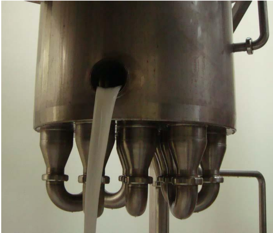
Figura 2 - Saída do equipamento fabricado em aço inoxidável austenítico.
