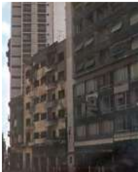
Edifício Andraus Efeitos do calor radiante em edifícios vizinhos
