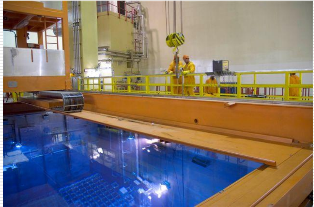
Piscina de estocagem de combustível irradiado – depósito inicial de alta atividade (HLW)
