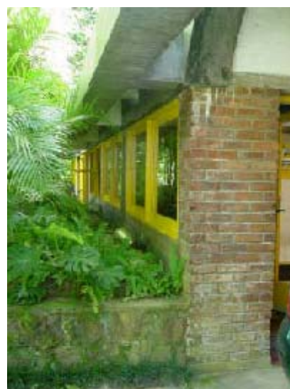
Detalhe do encontro da parede de tijolos à vista com a abóbada de tijolos. Faixa de janelas ao longo do corredor lateral da casa com a calha de cimento logo acima.
