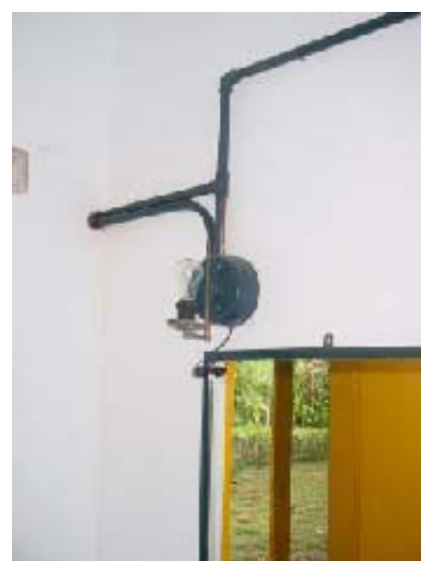
Detalhe da tubulação elétrica aparente por toda a casa.
