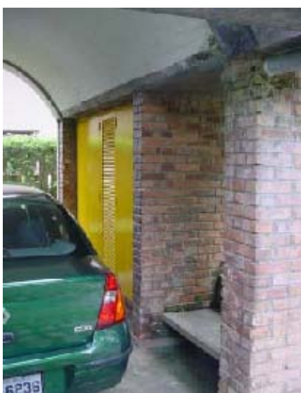
Detalhe do encontro da parede de tijolos à vista com a abóbada de tijolos. Ao lado do carro na garagem um prático armário para guardar material de praia e outros objetos de uso externo e do jardim.
