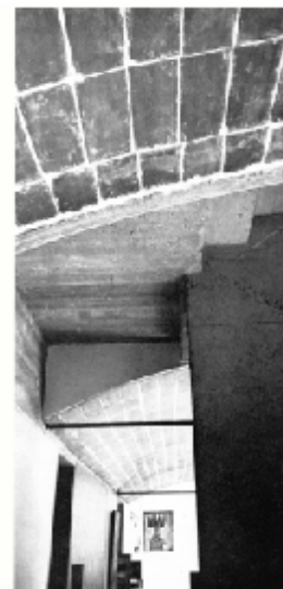
Le Corbusier, Neuilly (Paris), Casas Jaoul (conjunto de casas), 1956. Fonte: BANHAN, Reyner. “ El Brutalismo em Arqitettura ”, Ed. Gustavo Gilli, Barcelona, Espanha, 1967, p. 100. Detalhe do encontro da abóbada de tijolo com a parede.
