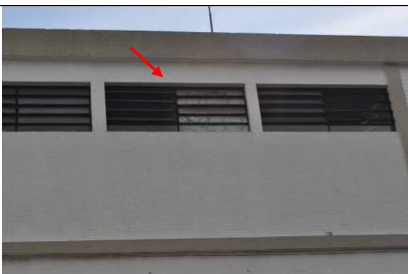
Figura 40 - Imagem da janela do 2º andar em que há blocos para fechamento de paredes. Foto: Deborah Neves (fev/2013)
