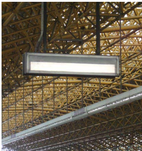
Figura 17.47 Os painéis de informação nas plataformas do sistema LRT2 de Manila forçam os usuários a ver mensagens comerciais antes de prover a informação pertinente de viagem.
