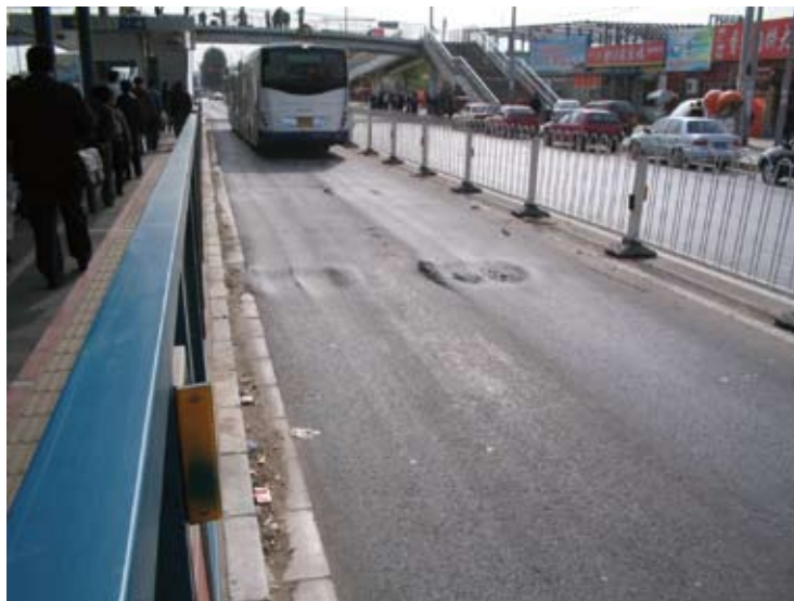
Figura 41 - Trecho de Pavimentação Danificada da Linha BRT 1 (Sul) em Beijing
