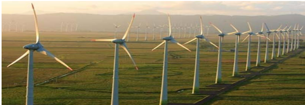
Aerogeradores em parque eólico no Rio Grande do Sul
