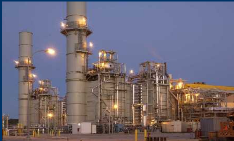
GERADORES DE VAPOR
