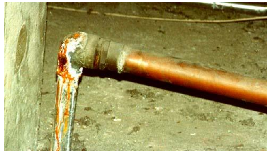
Corrosão Galvânica entre tubos de aço galvanizado e cobre
