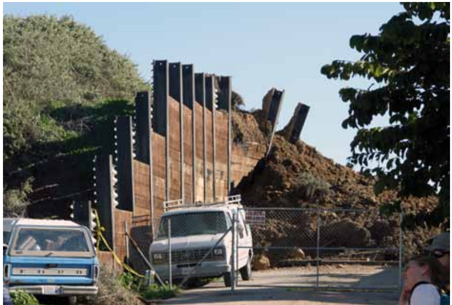
Figura C36. É necessário ter cuidado na localização e construção de muros de contenção de fluxos de detritos. Esta é uma fotografia da ruptura parcial de um muro de contenção, causada por um deslizamento em Iztapalapa, um subúrbio da Cidade do México, México. O deslizamento caiu sobre uma casa no pé da encosta, matando duas pessoas, e foi provocado pelas fortes chuvas na região. A casa estava abaixo do muro de 5 metros de altura (15 pés), mas a parede não pode suportar a massa de rochas e terra. (Fotografia por Chinagate / Xinhua).
