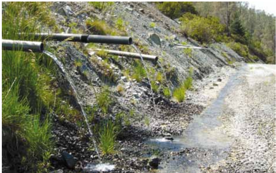
Figura C10. Esquema de tubos de drenagem. (Esquema da Referência 11.) Fotografia de canos de drenagem em um deslizamento de terra na Califórnia, EUA, por Andrew Alden.
