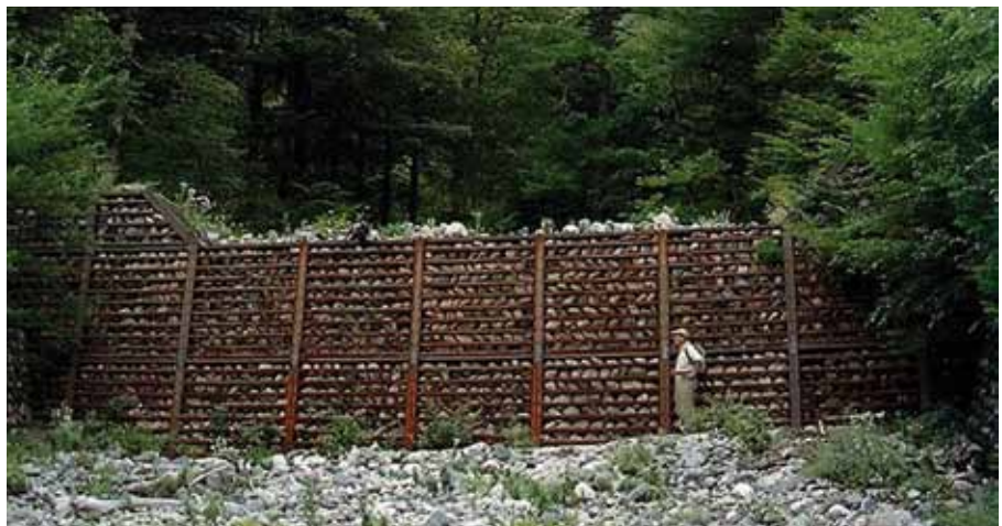
Figura C37. Um muro de contenção de fluxo de detritos na Bacia Kamikochi, Japão. (Foto cortesia de Gonçalo Vieira).
