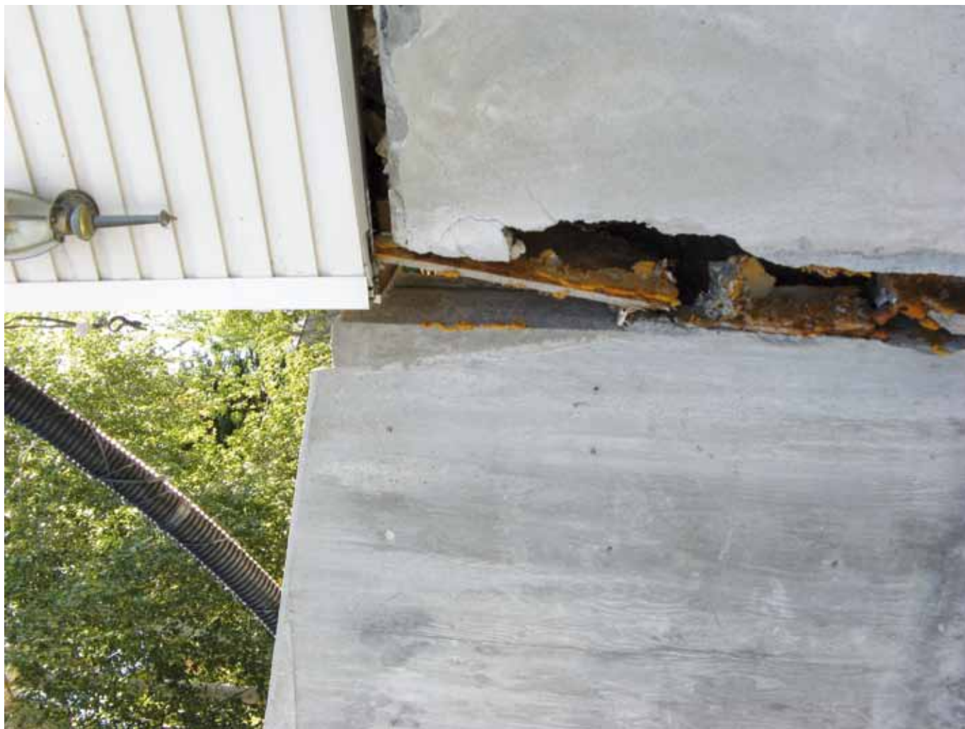
Figura 38. Figura 38. Rachadura na fundação de uma estrutura (Foto por Lynn Highland, U.S. Geological Survey).
