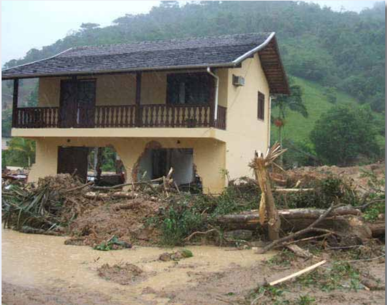
Casa destruída em Pomerode, SC (Novembro, 2008). Foto por Eng. Geotecnico Paulo R. Rogério
