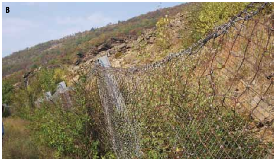
Figura C22. Barreira do tipo cerca de proteção contra rochas, ao longo de (A) uma trilha de lama na Pensilvânia, EUA, e (B) uma estrada na costa da Califórnia, EUA. (Fotografia da trilha, Lynn Highland, US Geological Survey e fotografia da estrada, Administração de Rodovias Federais, EUA).
