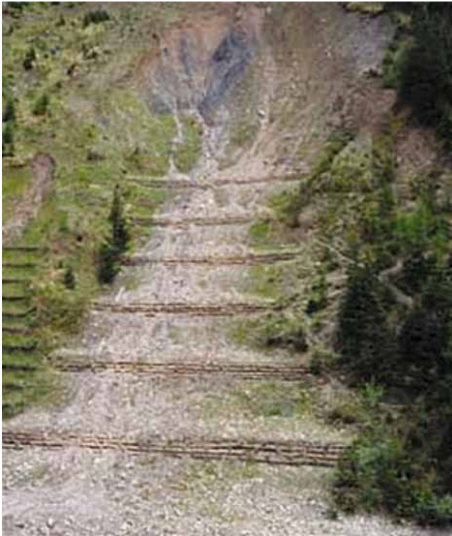
Figura C7. Desenho esquemático e fotografia de uma barragem de controle com parede de toras. (Gráfico de Referência 11, fotografia tirada em Trafoi, Itália, cortesia de “Erosion Control,” Forester Communications, Santa Bárbara, Califórnia, EUA.)
