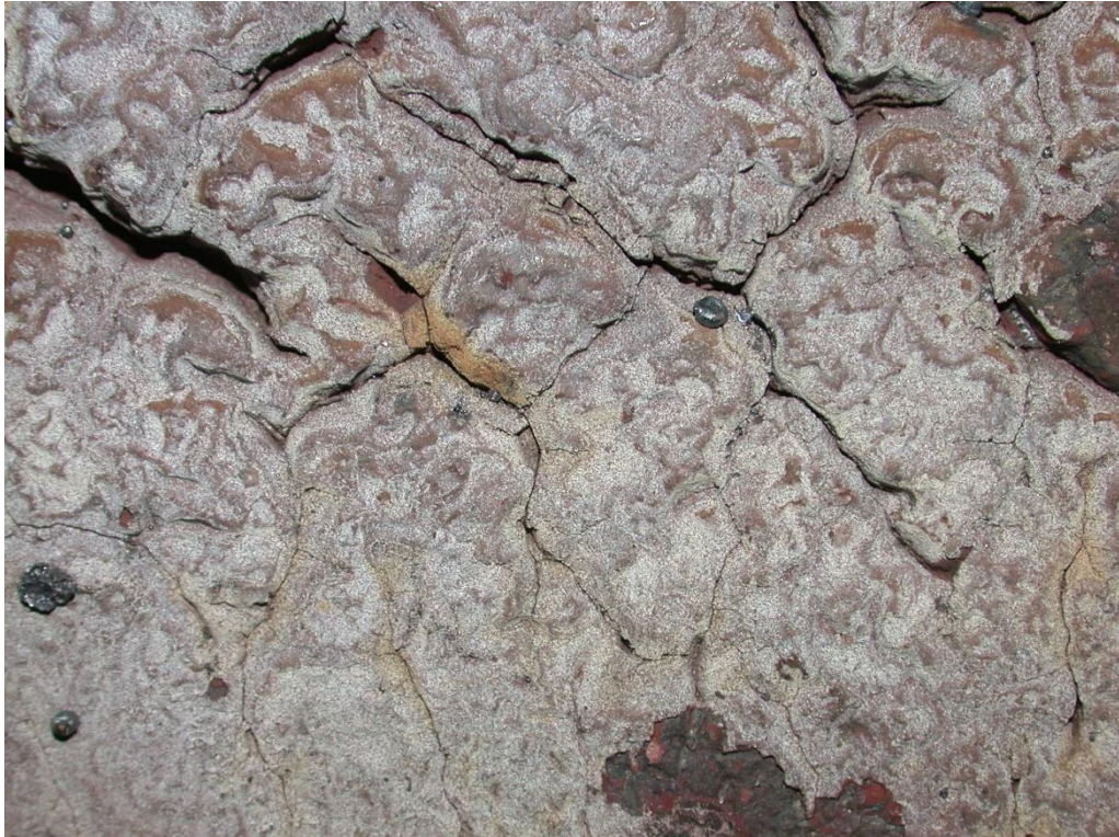
Figura 2 – Costado do tubulão da caldeira apresentando fendas profundas e trincas regularmente espaçadas na superfície, formando arranjos retangulares.
