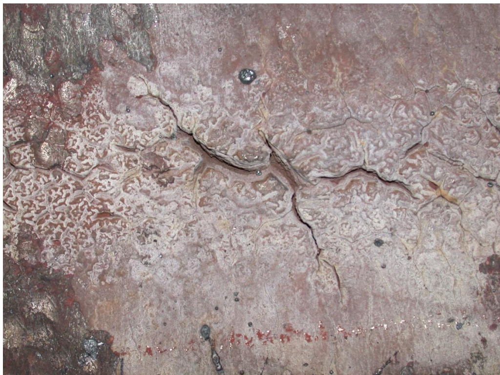
Figura 1 – Costado do tubulão da caldeira apresentando fendas profundas e trincas regularmente espaçadas na superfície, formando arranjos retangulares.
